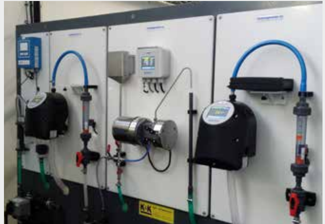
On-line analýzy, Úpravna pitné vody Železná Ruda
