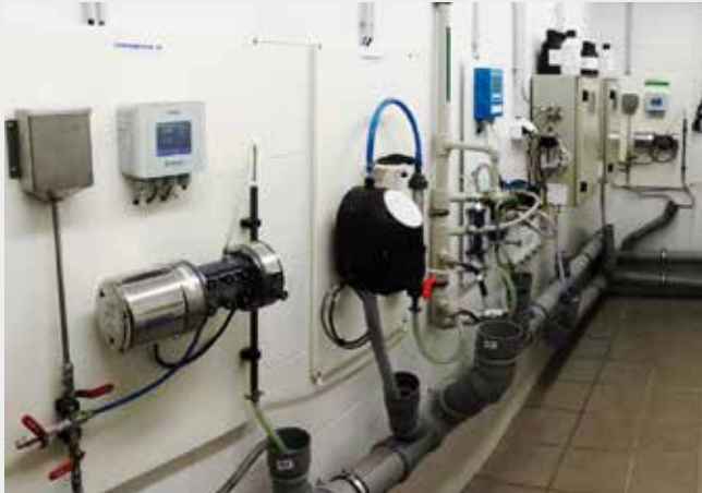
On-line analýzy, Vodárna Plzeň
